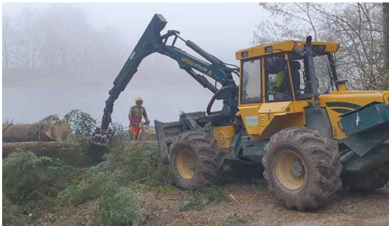
Als Vorbereitung auf die Sanierung fällt Forst Elgg die Bäume auf dem Damm.
